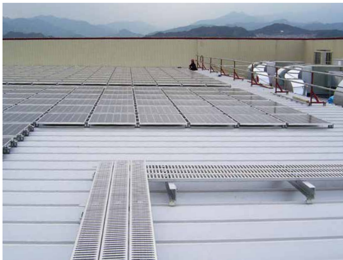
屋上点検通路 (MN型)
